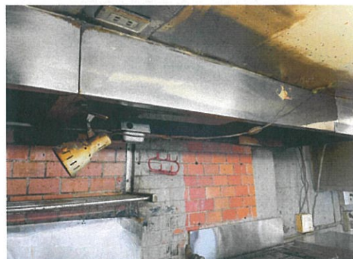
29：ダクト設備一式
